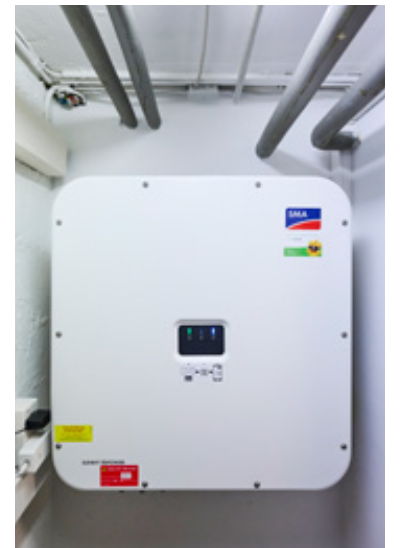
Der Wechselrichter der PV-Anlage.
